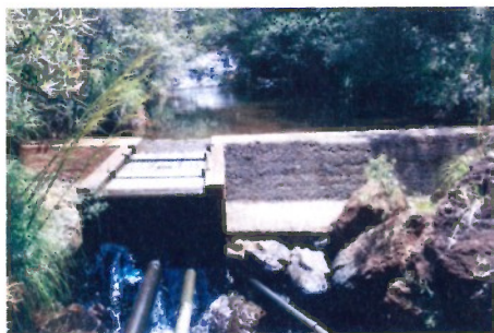
Le captage de La Néa, à Koné, avant et après de fortes pluies.
